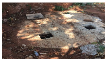
Figura 4 – Tanque séptico destampado
