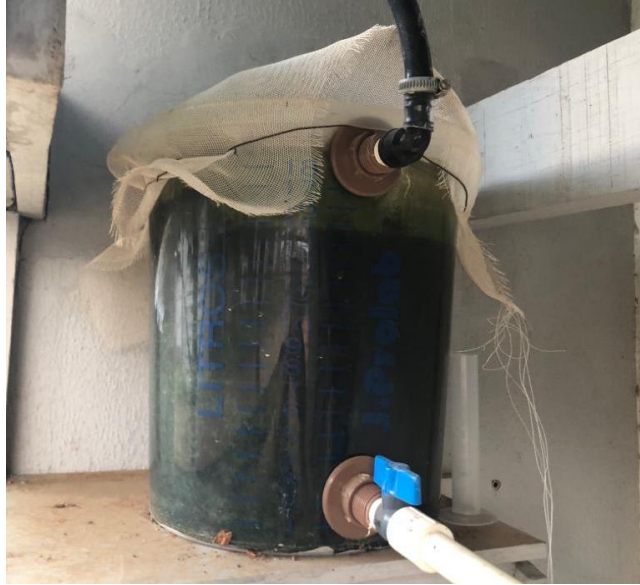
Figura 4 – Tanque de equalização (afluente)
