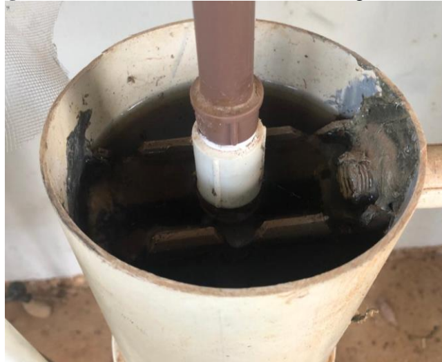
Figura 5 – Canaleta com vertedores triangulares (R1)
