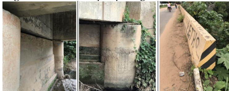
Figura 20 – Manifestações patológicas encontradas na Ponte 02
