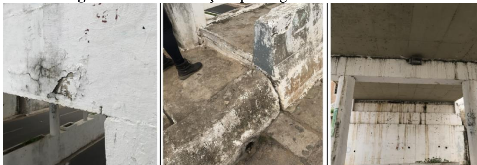
Figura 29 – Manifestações patológicas encontradas na Ponte 03
